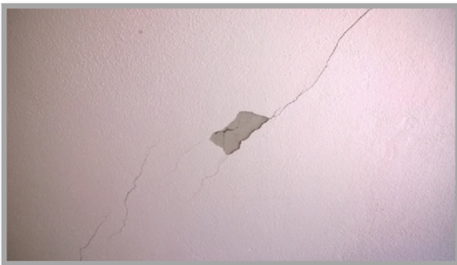
Obrázek č.8: (Trhlina ve sklepním prostoru)
