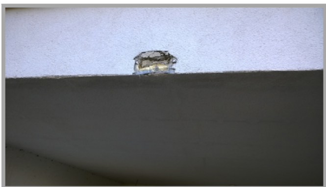
Obrázek č.3: (Mechanické poškození zateplovacího systému)
