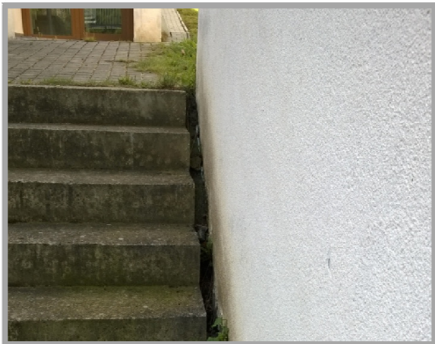
Obrázek č.1.: (Mezera mezi schodištěm a fasádou)
