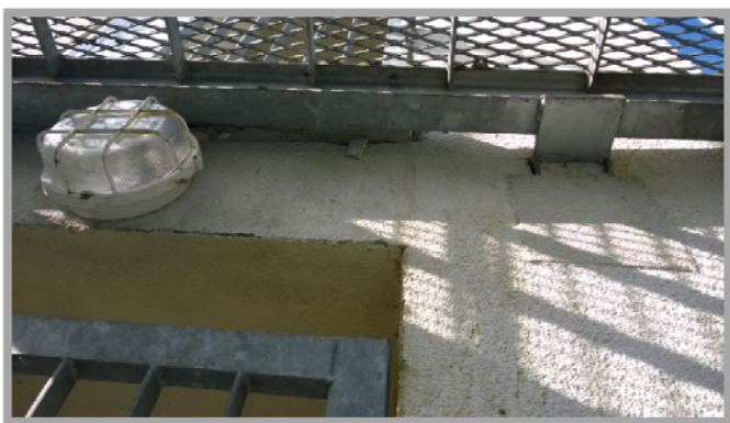
Obrázek č.2: (Chybějící lišta u požárního schodiště)
