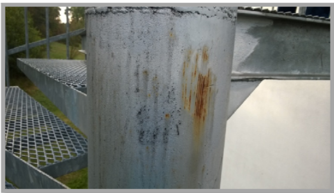
Obrázek č. 4: (Koroze ocelového schodiště – ilustrační obrázek z objektu č.p. 44)
