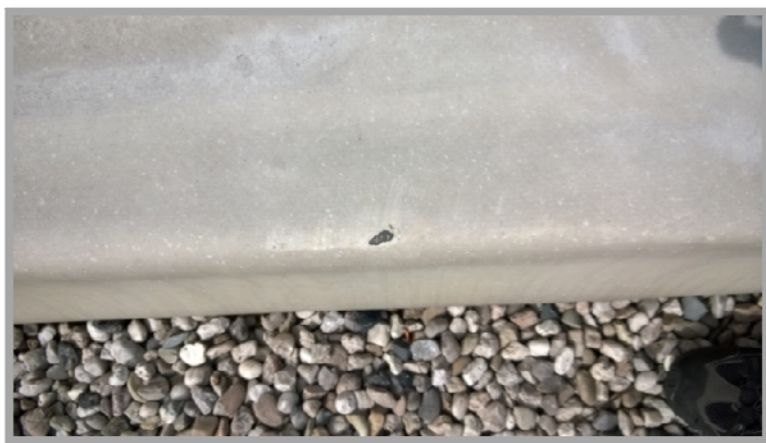
Obrázek č.4. : (Poškození na folii)
