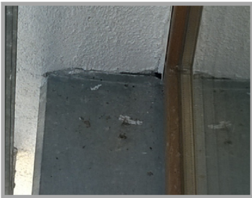
Obrázek č.5 : (protispád parapetního plechu schodiště)
