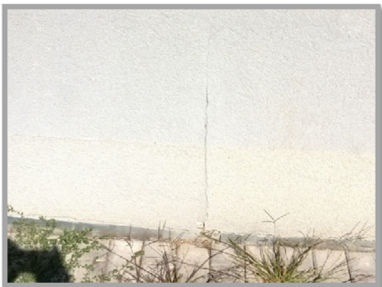
Obrázek č.1: (trhlina ve fasádě)
